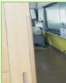
타사 안전도어 설치된 여닫이 목문입니다.
